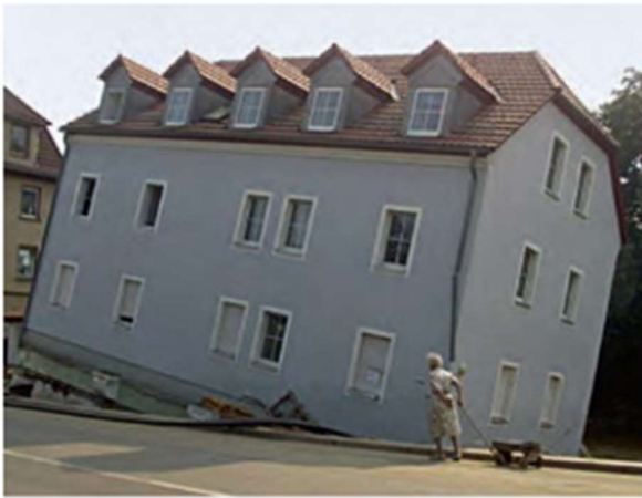
Abbildung 5: Gekipptes Haus durch Unterspülen. ©Sebastian Gölz (IÖR)
