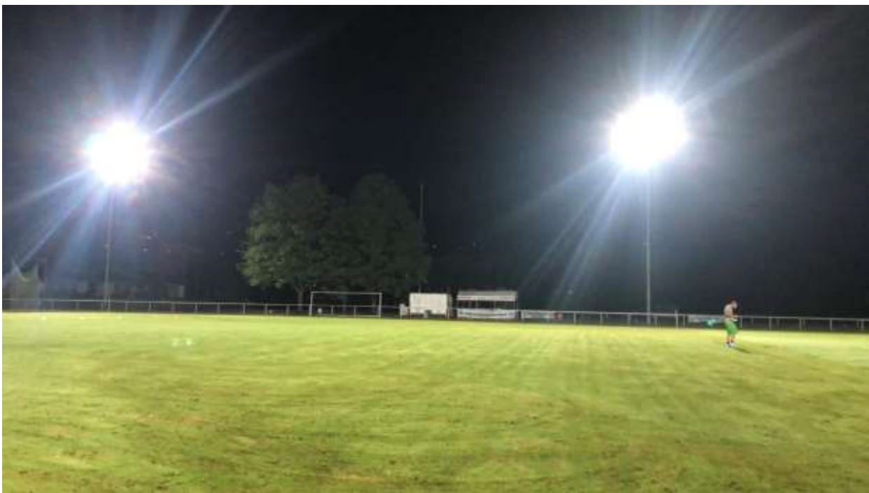
Flutlichtanlage des Naturrasenplatzes am Sportzentrum Nassau nach der Sanierung
