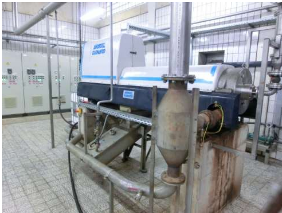
Abbildung 4-30 Zentrifuge zur Klärschlammmentwässerung
